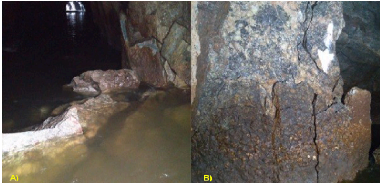
Figura 6.2-3. A) Situação em 28/12/2020 mostrando novo colapso da capela do trecho 110m. B) Detalhe da parede do túnel no trecho 110m, mostrando trechos ainda por cair.
