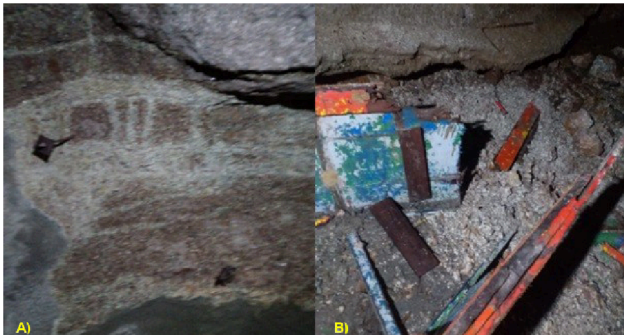
Figura 6.2-4. A) Situação de 05/01/21 mostrando trecho do Respiro, em situação de intersecção de falha geológica com veio pegmatítico, que sofreu ruptura de bloco do teto. B) Detalhe do bloco caído, que danificou a embarcação atracada nessa entrada de serviços (respiro).
