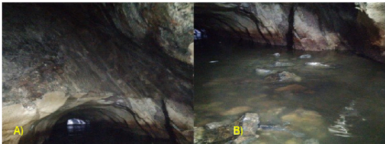
Figura 6.3-2. A) Situação em 12/01/21 mostrando a capela do trecho 110m, mostrando os limites da parede sul da capela, parecidos com os da vistoria anterior. B) Outra vista do mesmo trecho, com enfoque na parede oeste, e mostrando o aumento da cavidade, embora limitado entre os planos de foliação com a mesma dimensão na direção perpendicular à foliação, e aumento nas direções paralelas à foliação.
