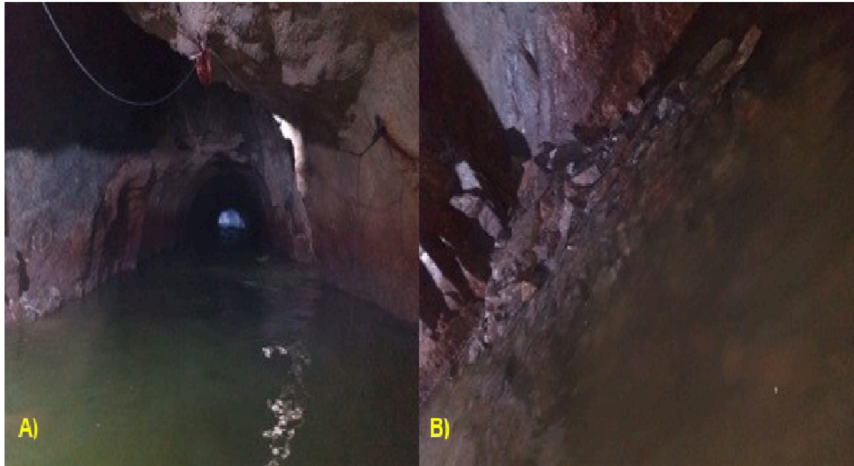
Figura 6.2-5. A) Situação em 07/01/21 após limpeza das quedas de blocos de 28/12/20. B) 11/01/2021 Mostrando novas quedas de blocos após limpeza concluída em 07/01/21.
