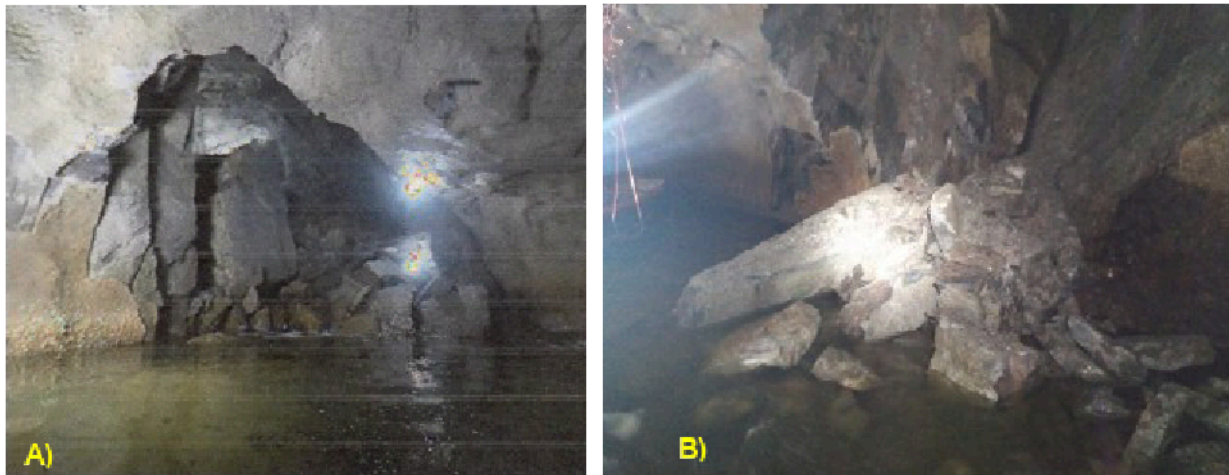
Figura 6.2-1. A) Na vistoria de 28/10/2020, na área do colapso de 110m foi identificado blocos que deveriam ser desmontados, pois configuravam risco de ruptura. B) Situação em 24/11/2020 mostrando as rochas desmontadas após a recomendação.
