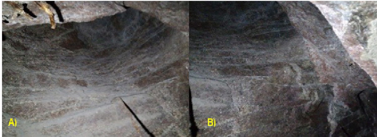
Figura 6.3-1. A) Situação em 12/01/21 mostrando a capela do trecho 240m. B) Outra vista do mesmo trecho, com alguns elementos fixadores expostos, e mostrando a composição pegmatítica com acentuada alteração dos minerais originais para argilas cauliniticas.
