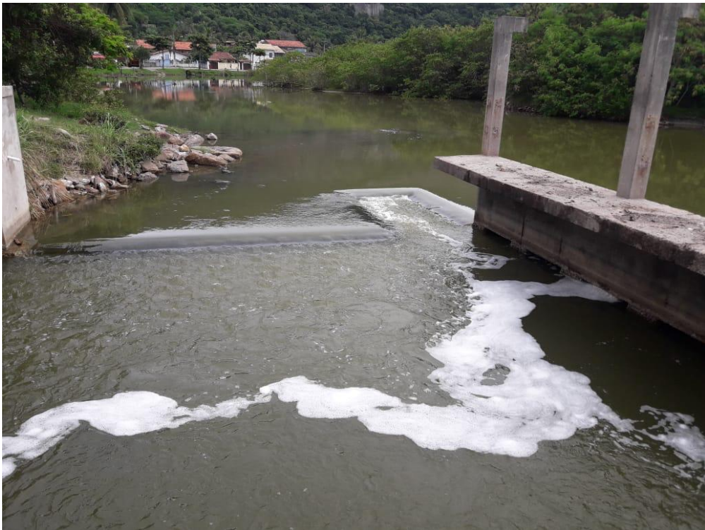
Imagem 10 - Situação atual do Túnel do Tibau
