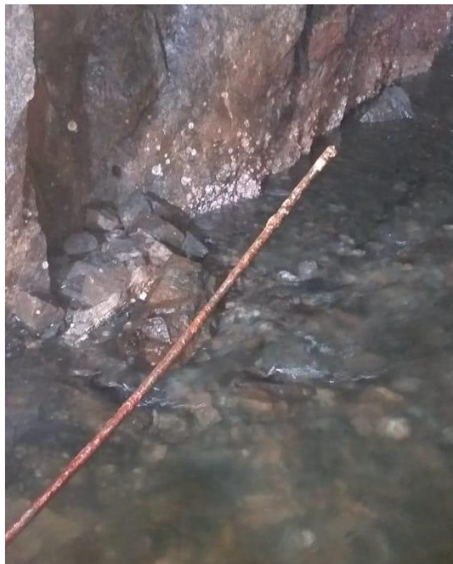
Imagem 4 Situação atual do Túnel do Tibau
