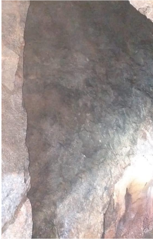
Imagem 5 - Situação atual do Túnel do Tibau
