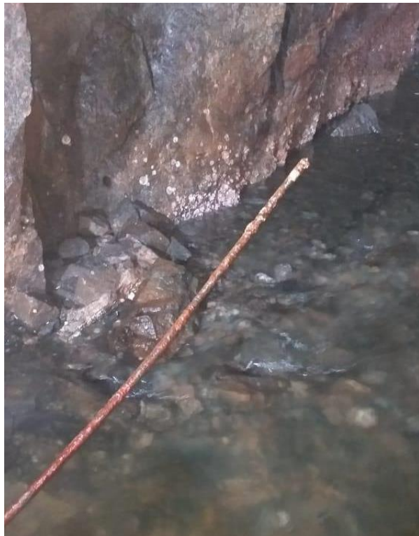
Imagem 8 - Situação atual do Túnel do Tibau
