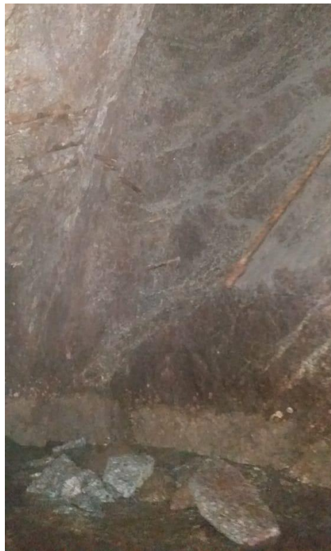
Imagem 6 - Situação atual do Túnel do Tibau
