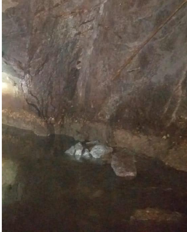
Imagem 7 - Situação atual do Túnel do Tibau
