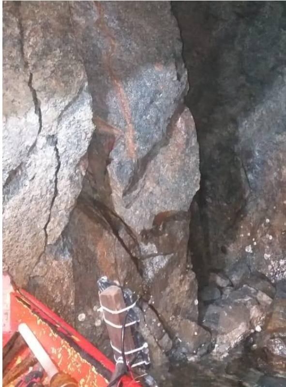
Imagem 3 - Situação atual do Túnel do Tibau
