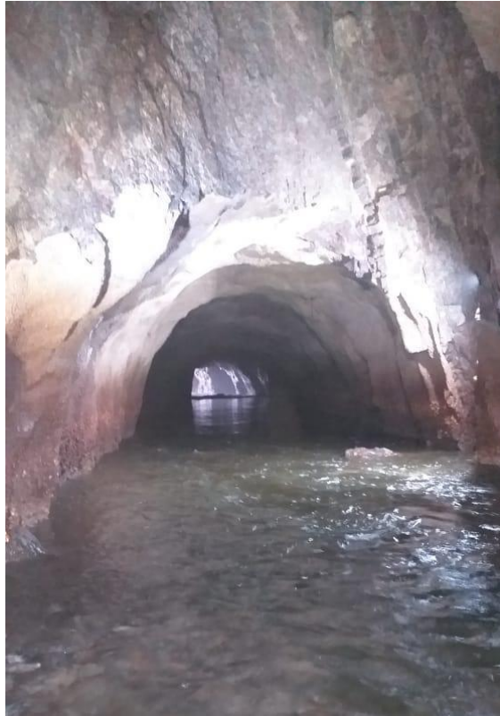
Imagem 1 - Situação atual do Túnel do Tibau
