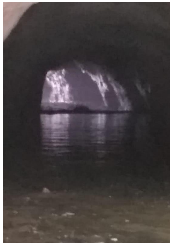
Imagem 2 - Situação atual do Túnel do Tibau
