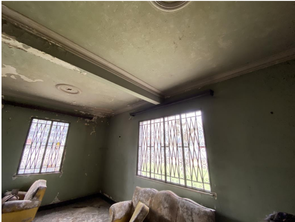
Foto 1- Sala 3, viga chegando na janela.
