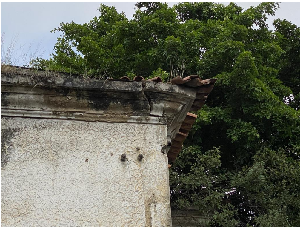
Foto 15 – Trechos em mau estado com perigo de queda.
