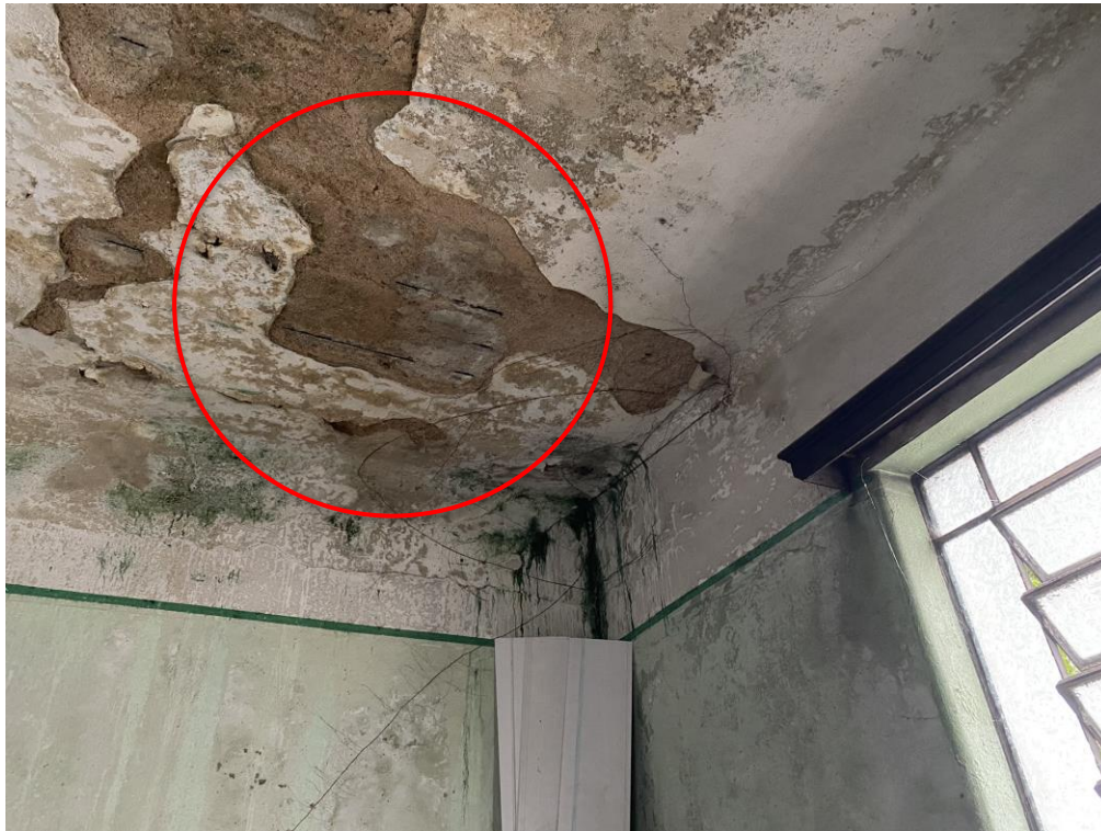
Foto 8 – Vista da laje do quarto 5, vendo-se armaduras aparentes.
