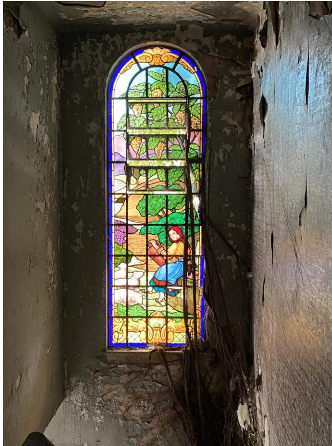
Foto 13 – Vitral na Sala 4, já sendo atingido pela vegetação.
