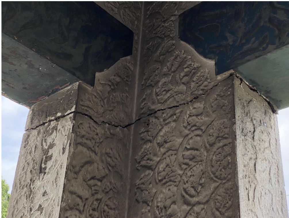
Foto 12 – Trinca na cabeça do pilar, vista interna.
