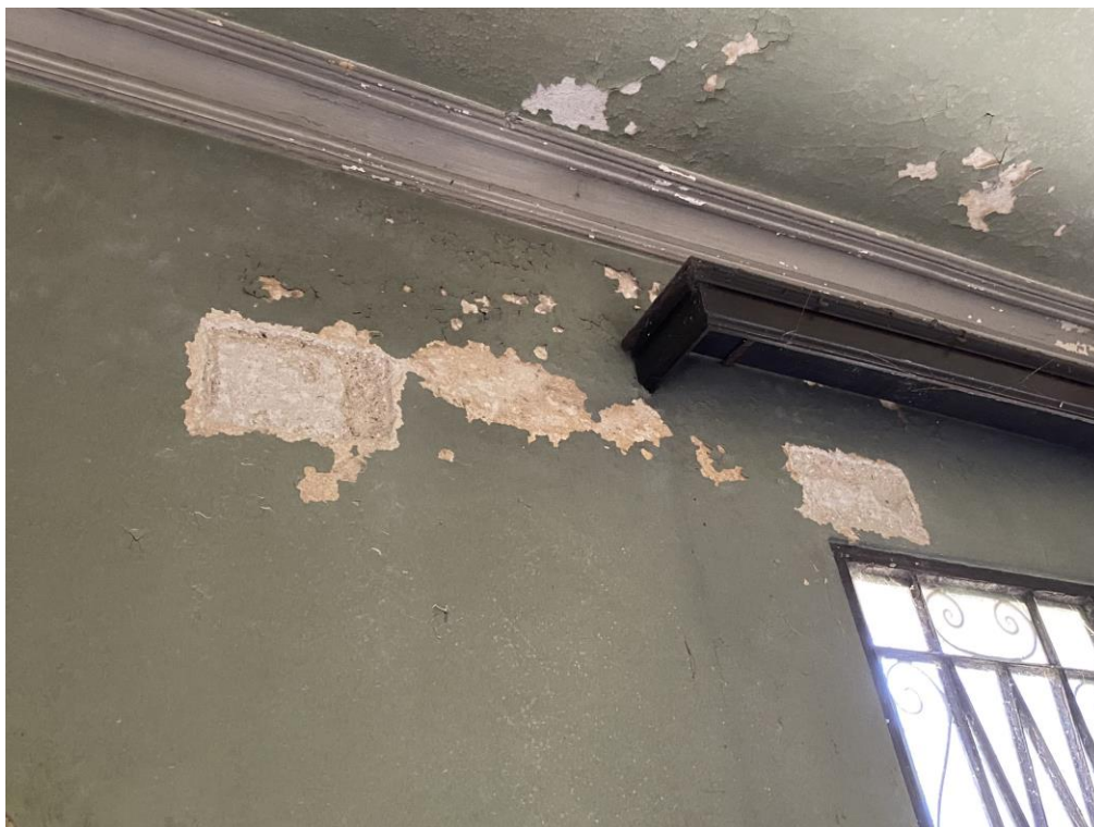
Foto 2 – Pesquisa para detectar a cinta sobre a alvenaria, onde a viga se apoia.
