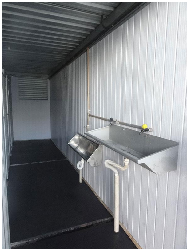
Figura 3 – Vista interna de contêiner vestiário com mictório e pia para lavagem das mãos. Fonte: Empresa API, 2020.
