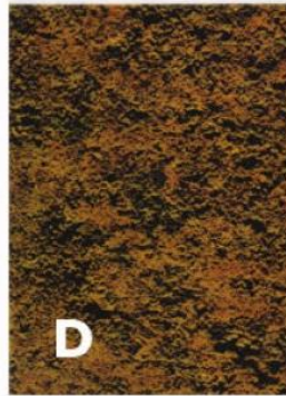
7.a Aspecto da superfície antes da limpeza
