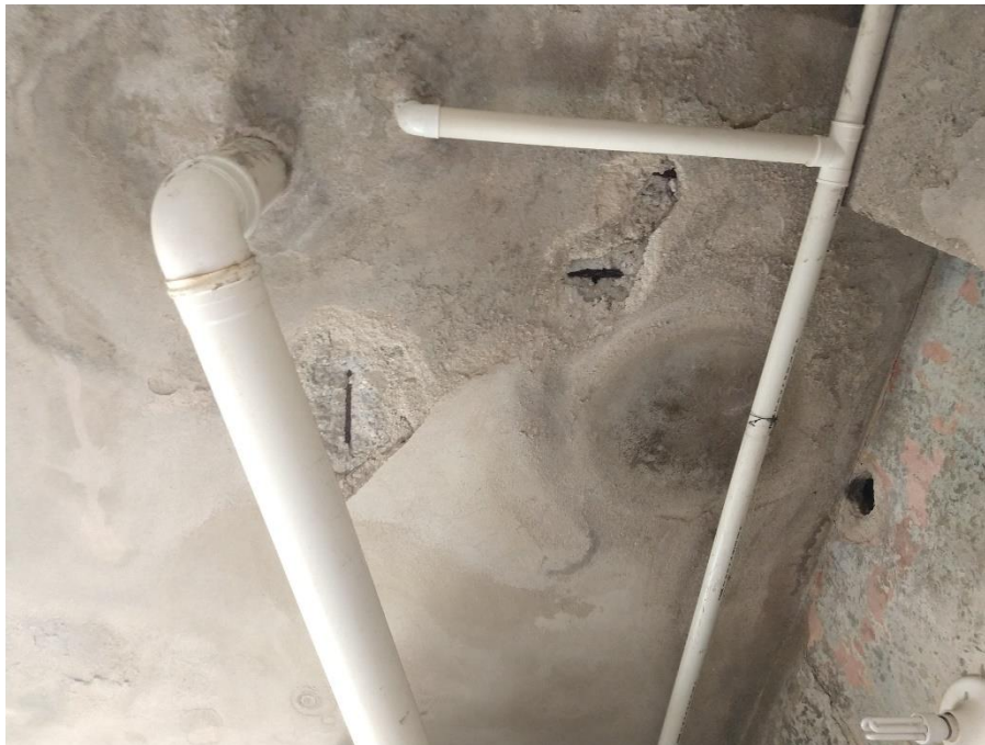
16 b – Exposição da armadura da laje.
