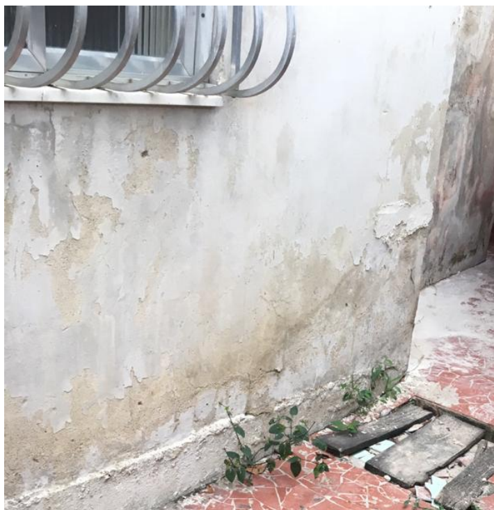
Figura 14 - desagregação e descolamento da massa
