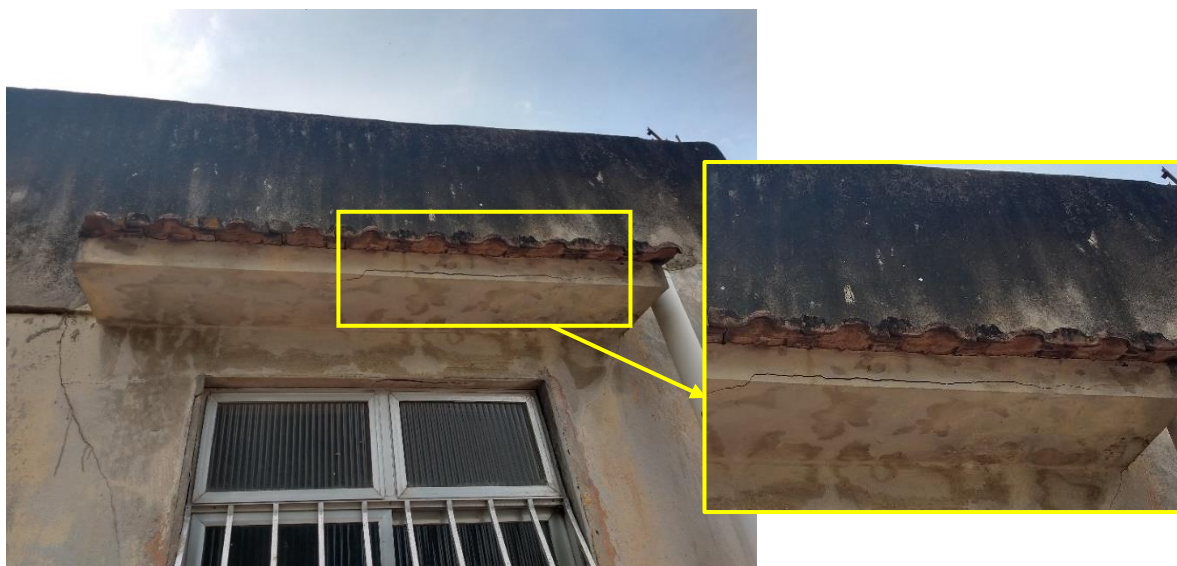
Figura 10 – platibanda com fungos e beiral da janela com infiltração e fissura.
