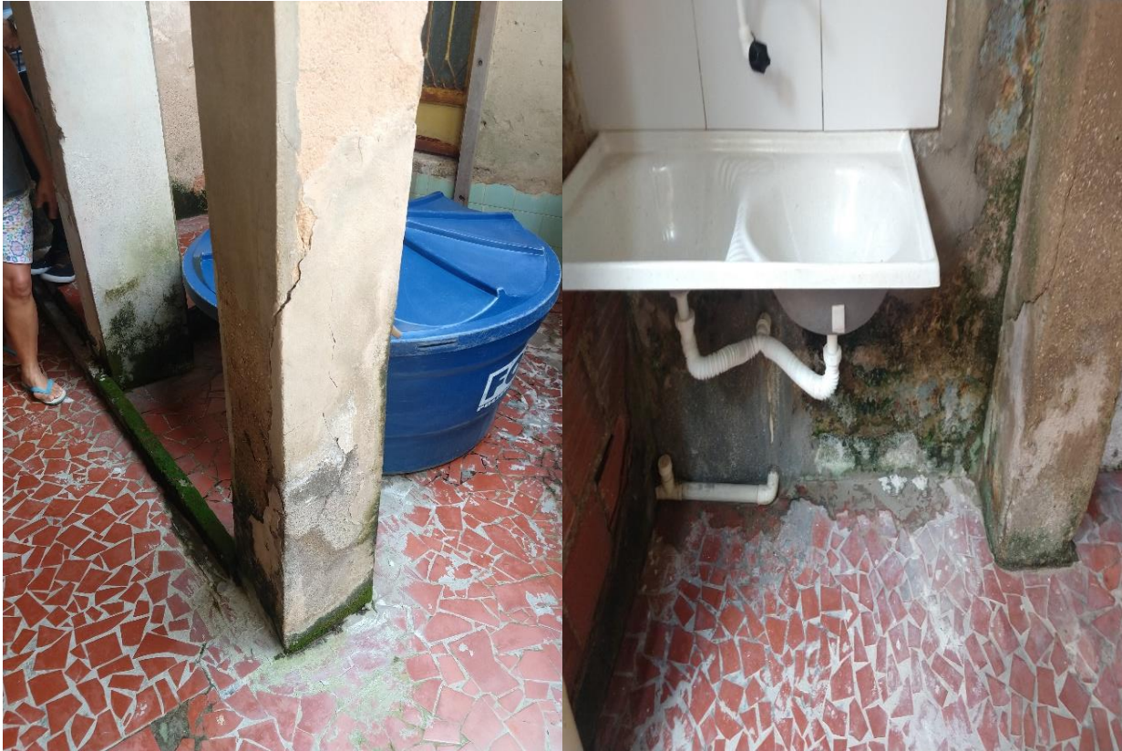
Figura 15 - infiltração em base de pilar e descolamento do revestimento.
