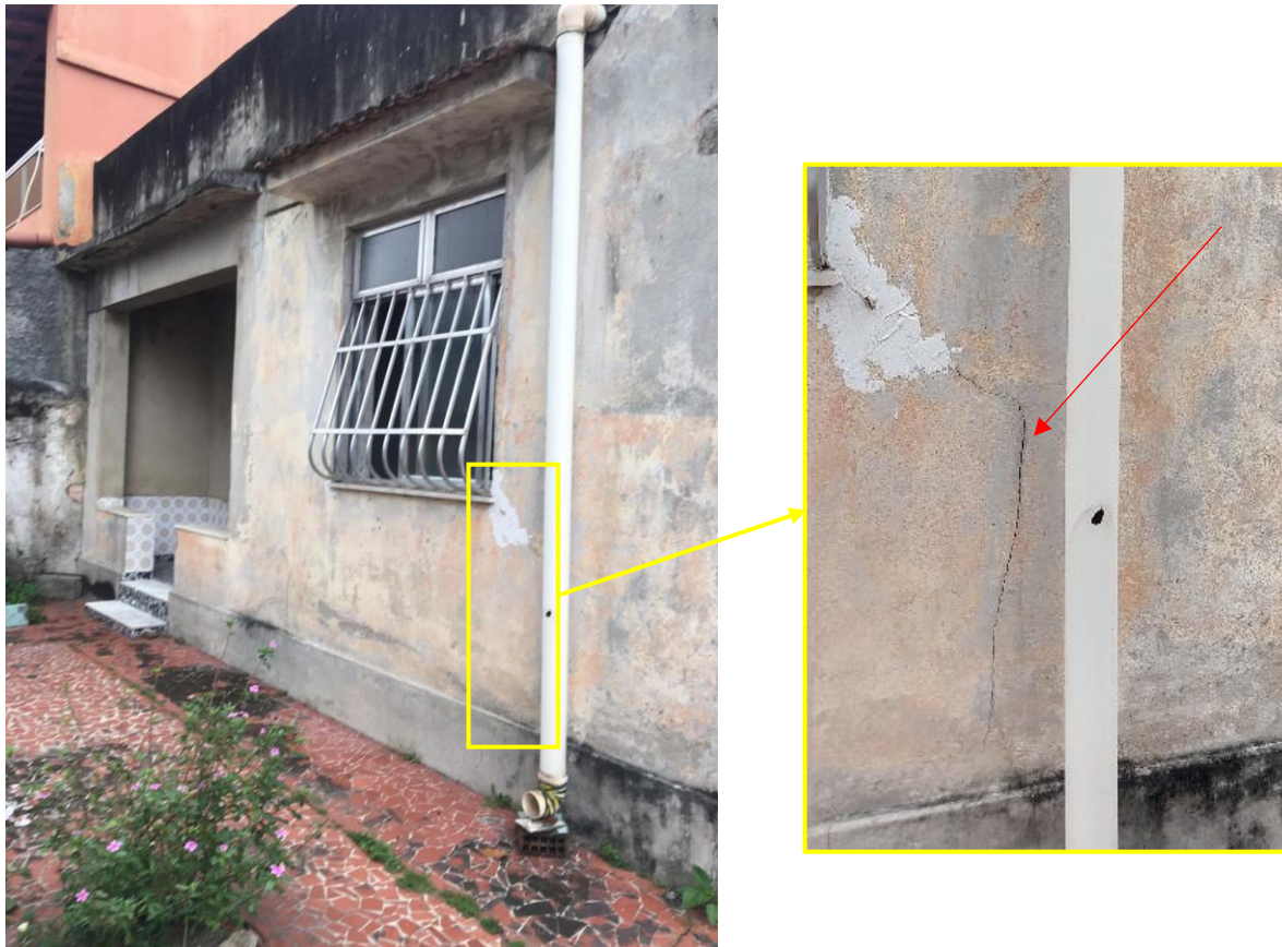
Figura 12 – fissuras canto inferior direito da janela.
