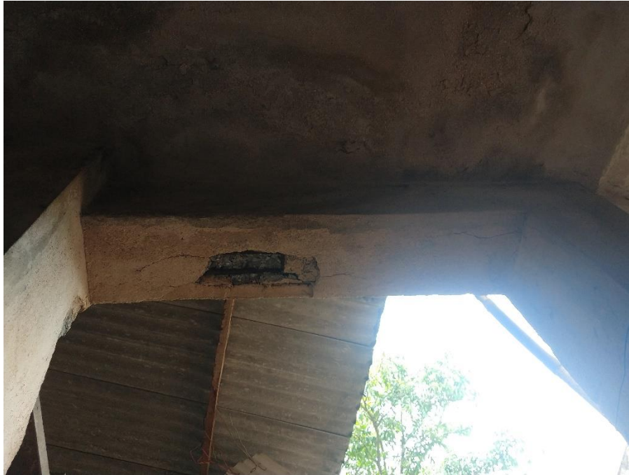
16 a – Exposição da armadura da viga.
