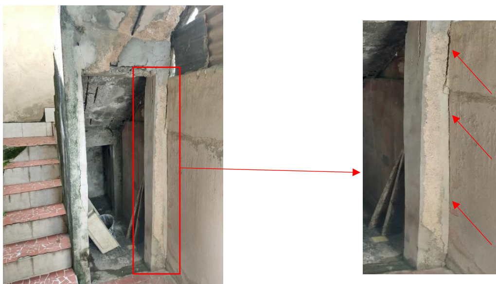
Figura 7 – rachadura entre muro e pilar
