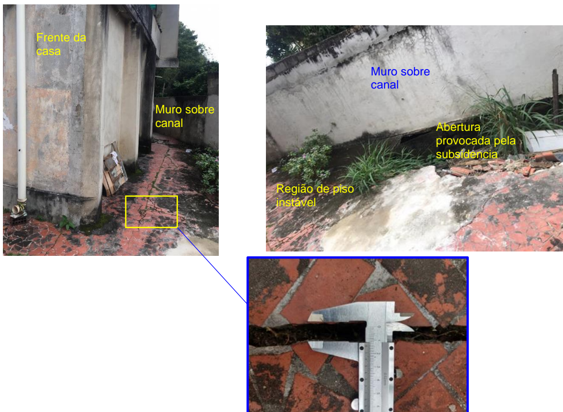
Figura 6 – Região de piso instável junto ao muro divisa com canal.
