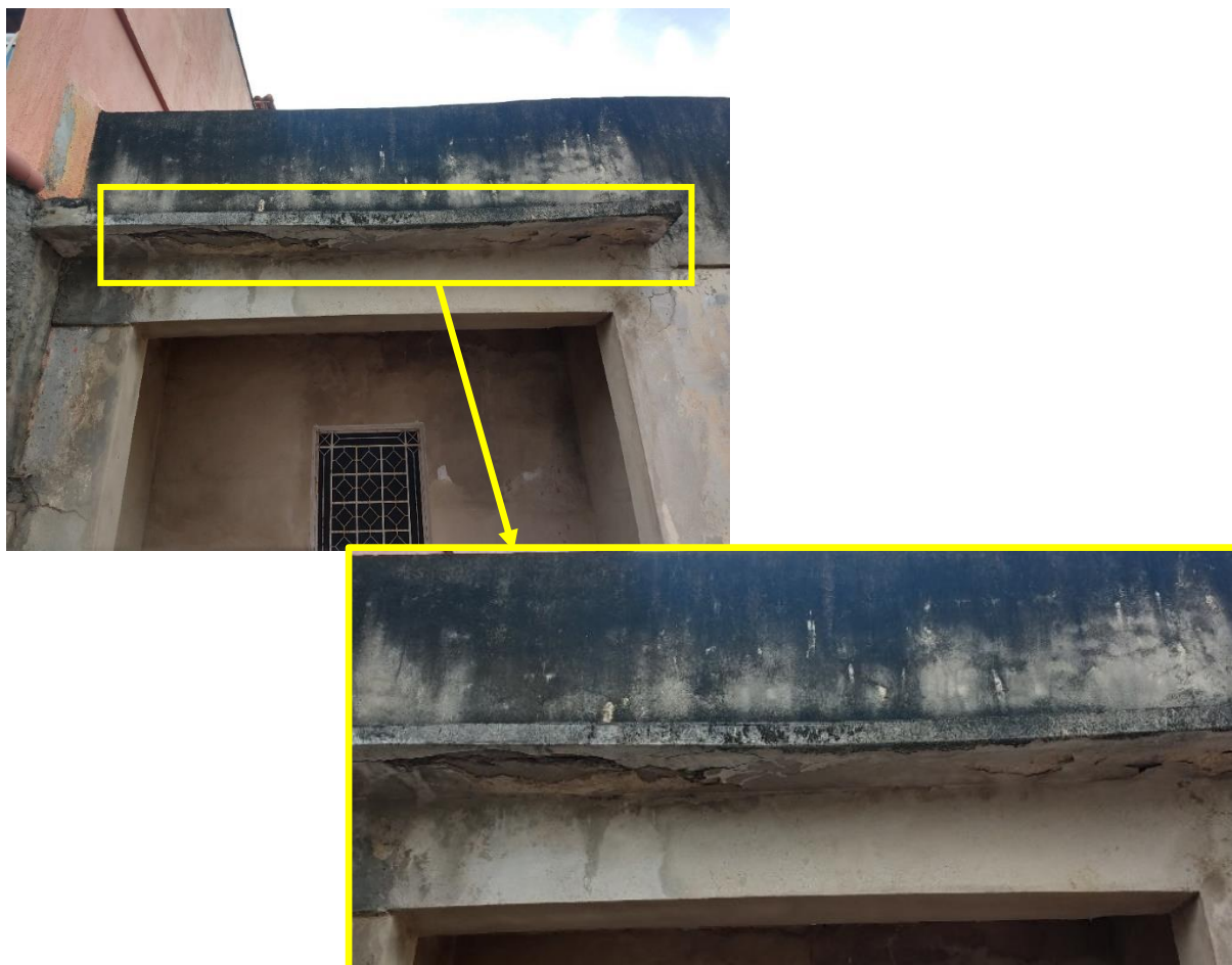
Figura 11 – platibanda com fissuras e fungos e beiral do portal de entrada com armadura exposta.
