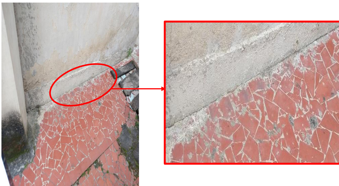
Figura 8 – rachadura entre muro e piso.
